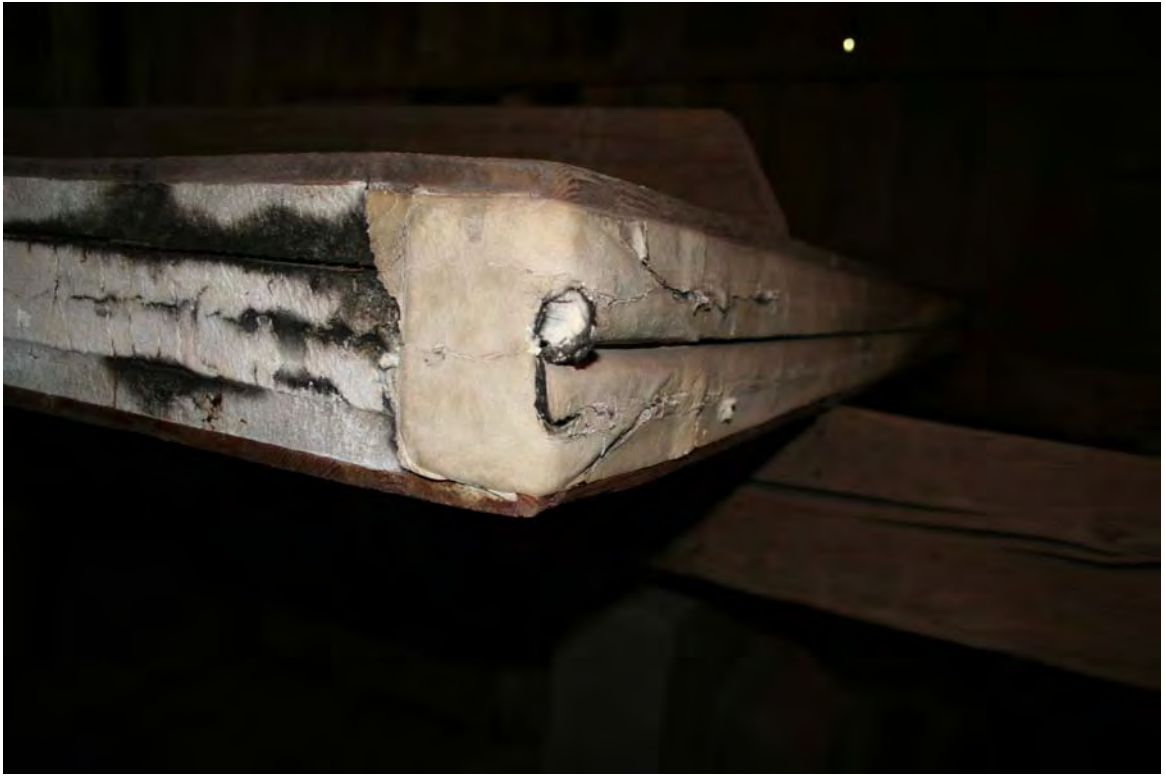
Abb. 029 Balgscharnier vor der Restaurierung (Juli 2006)
