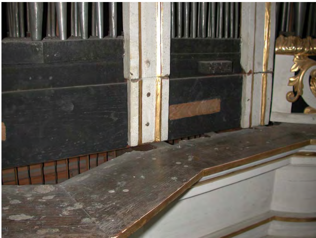
Abb. 024 Manuallade mit abgenommenen Spundverschlüssen Juli 2006
