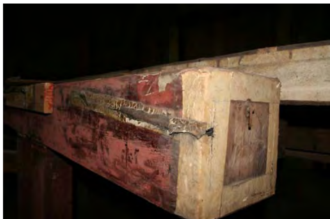
Abb. 028 Sammelkanal vor der Restaurierung Juli 2006
